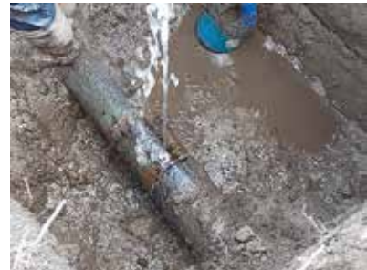
竹谷支線における漏水の状況
