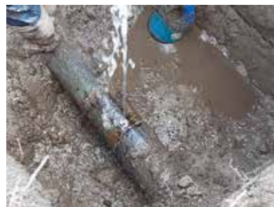
竹谷支線における漏水の状況
